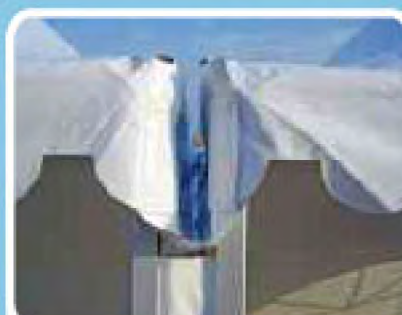
水槽 rain gutter
