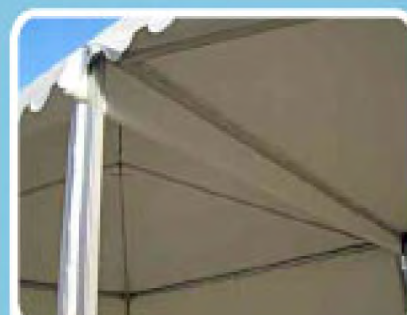
水槽 rain gutter
