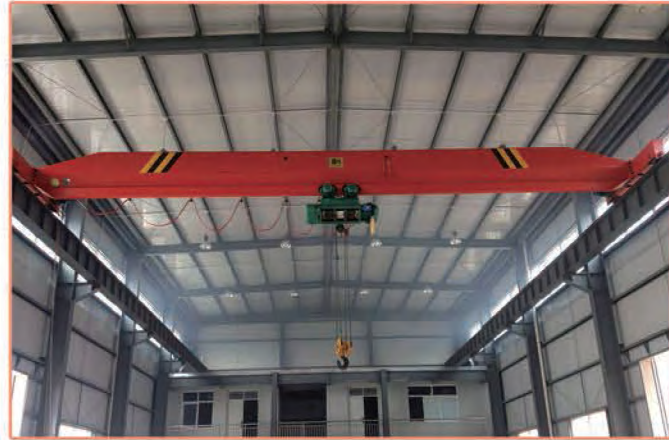
Single Beam Crane 单梁起重机
