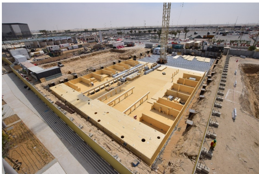
Översiktsbild över byggnationen av den svenska paviljongen, den 20 februari 2020. På bilden syns i överkant det skumglaslager som låg mellan sanden och trägrunden, och i bildens underkant syns trägrundläggningen med hål för de nära 300 trädstammarna. Foto: Expo-sekretariatet.
