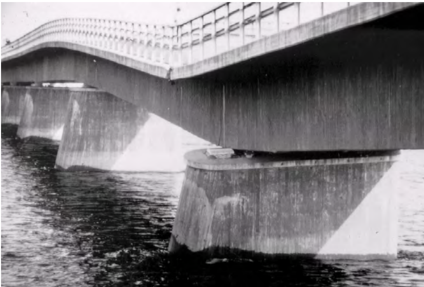
Figur 4 Erosionsskada vid Kangosfors i Lainio älv 1975
