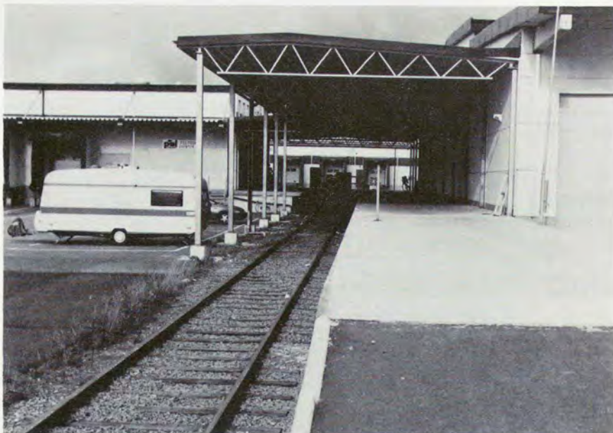
Nybyggt industrispår i Helsingborg
