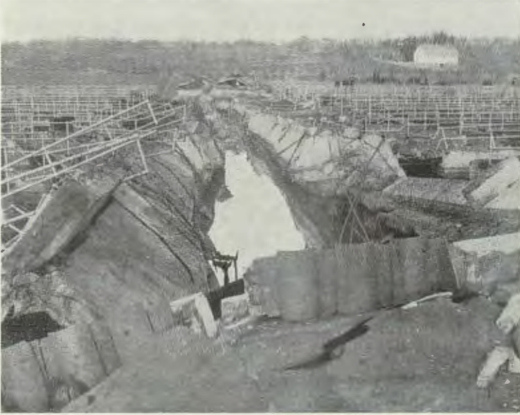
Fig. 71. Rörtunnel efter explosion av läckande slamgasledning. Dayton, Ohio.
