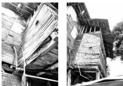
Se observa instalaciones hidráulicas en el exterior; tanto de la cocina, como del baño. El volumen adosado es reciente y corresponde al baño.
