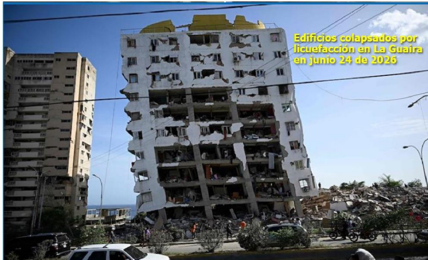
Falla estructural de un edificio por amplificación sísmica y desplomes por licuefacción de suelos, en la Guaira. CNN y Jaime Suárez D.
