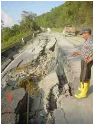
Figura 6.7 Deslizamiento por lluvias acumuladas. Las aguas se infiltran a profundidades mayores y activan movimientos en masa que involucran volúmenes grandes de suelo. (Carlos E. Escobar P.)
