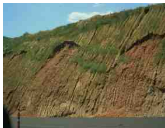
Figura 1.1 Talud inestable por deslizamientos superficiales y erosión en surcos. Las ciclas de cascada hasta la deshidratación.
