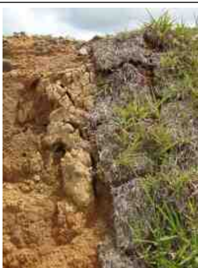
Figura 3.2 El suelo de la corona del talud es inestable: la contracción y el agrietamiento inducidos por el secado del sol y el viento, hasta la deshidratación del suelo lo hace perder su funcionalidad.
