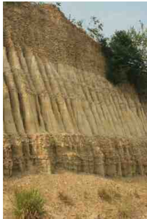
Figura 8.1. Talud vial afectado por erosión. Las lluvias torrenciales adquieren la energía para labrar el talud en forma de surcos de erosión; el viento modela las formas redondeadas. En el pie del talud se depositan los sedimentos producidos por la erosión. (Carlos E Escobar P).
