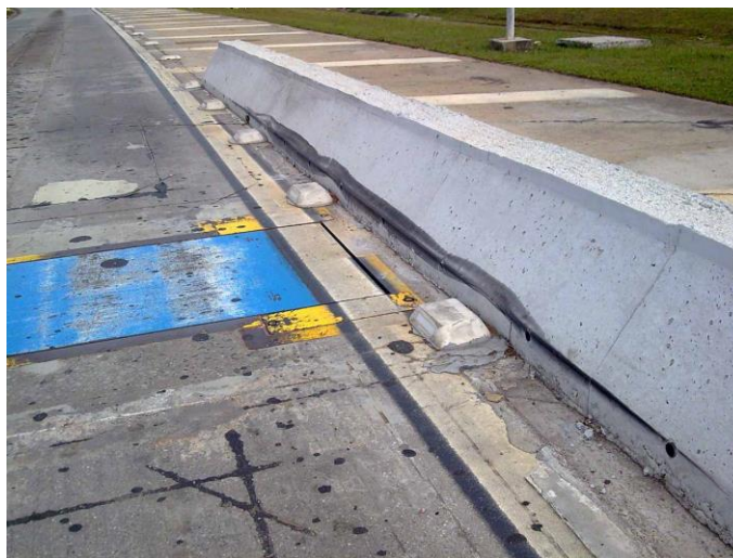
FIGURA 71 – Danos à mureta de contenção
