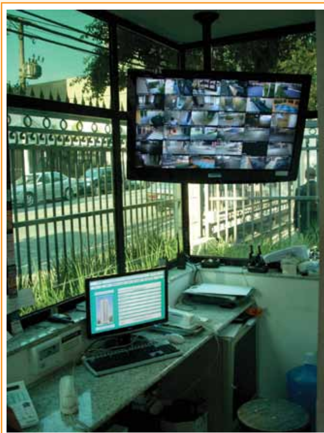
Figura 4 – Sistema de supervisão e controle do edifício instalado na portaria.
