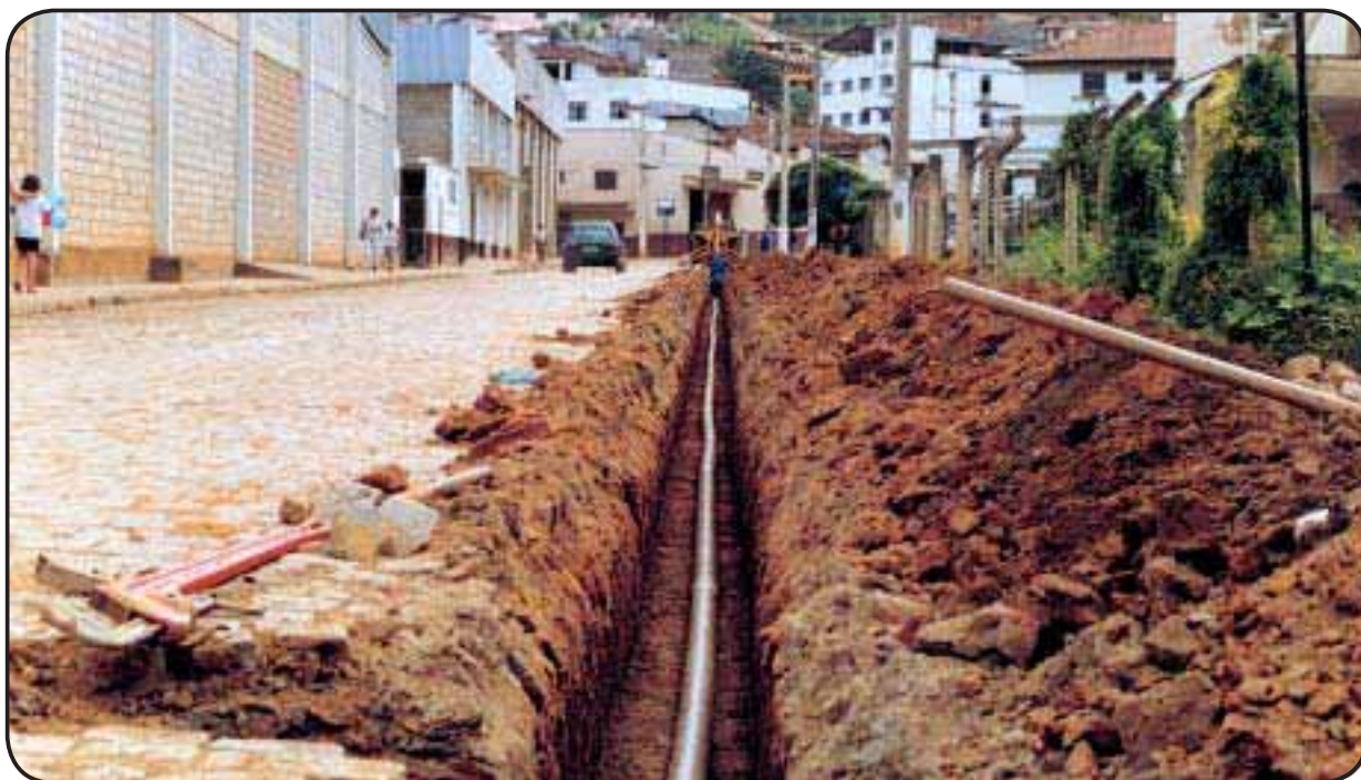
Foto 6 — Rede de distribuição em PVC PBA
