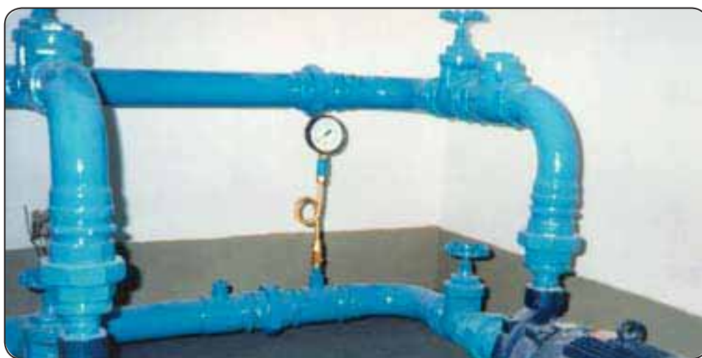
Foto 7 — Estação elevatória de água tratada
